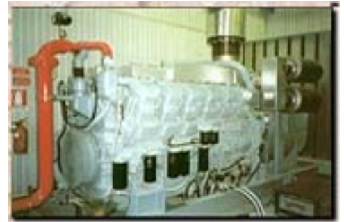
Meyer 医院热电联产设施
